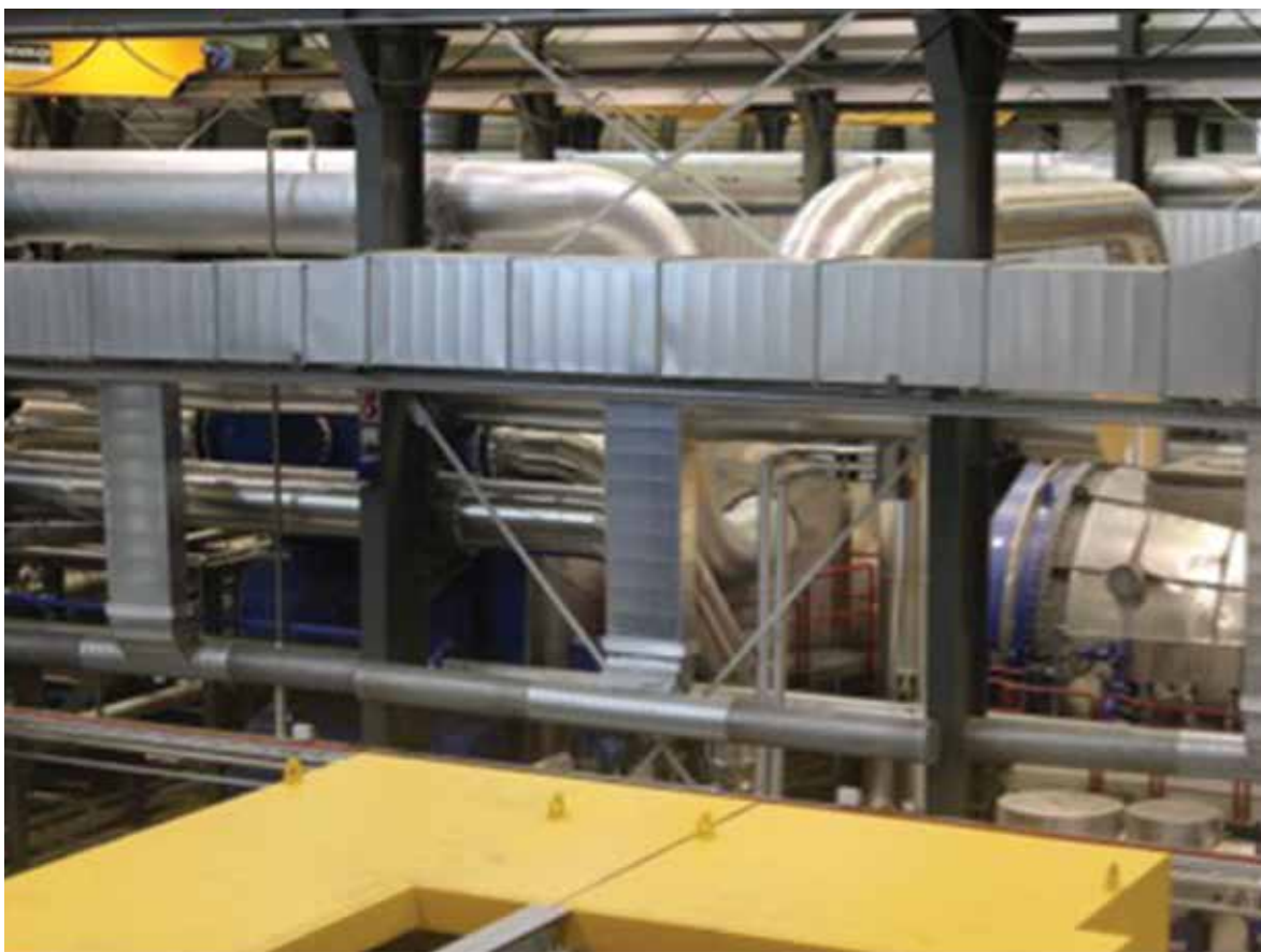
Fig. 1. Hellisheid geotermisk anlæg. I baggrunden ses de dampturbiner der omdanner dampen til elektricitet. Foto: Nadia Winther
