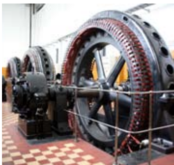
Gudenaacentralens maskinhal med generatorer.
