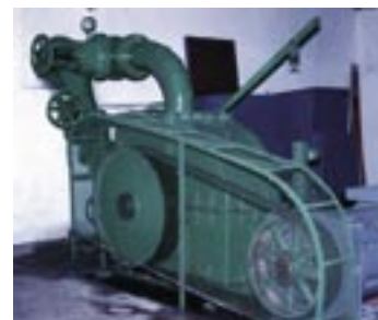
Et microhydropower vandkraftværk i bjergbyen Sikles på 100 KW. (Billedet er venligst stillet til rådighed af Annapurna Conservation Area Project)
